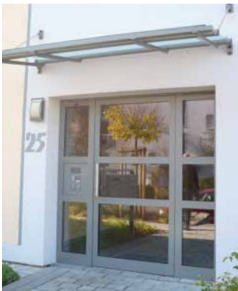
Auch hier stammt alles von Hirschhäuser – vom Vordach über die Tür bis hin zu Briefkasten und Treppengeländer
